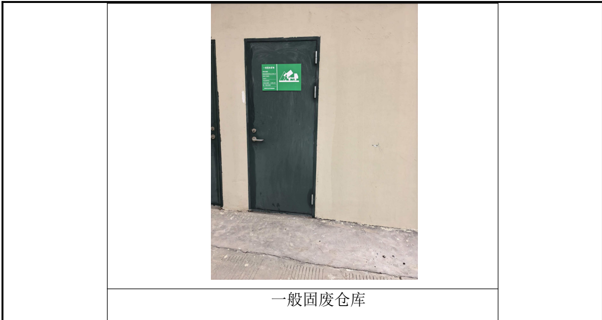
图 3-3 一般固废贮存场所
